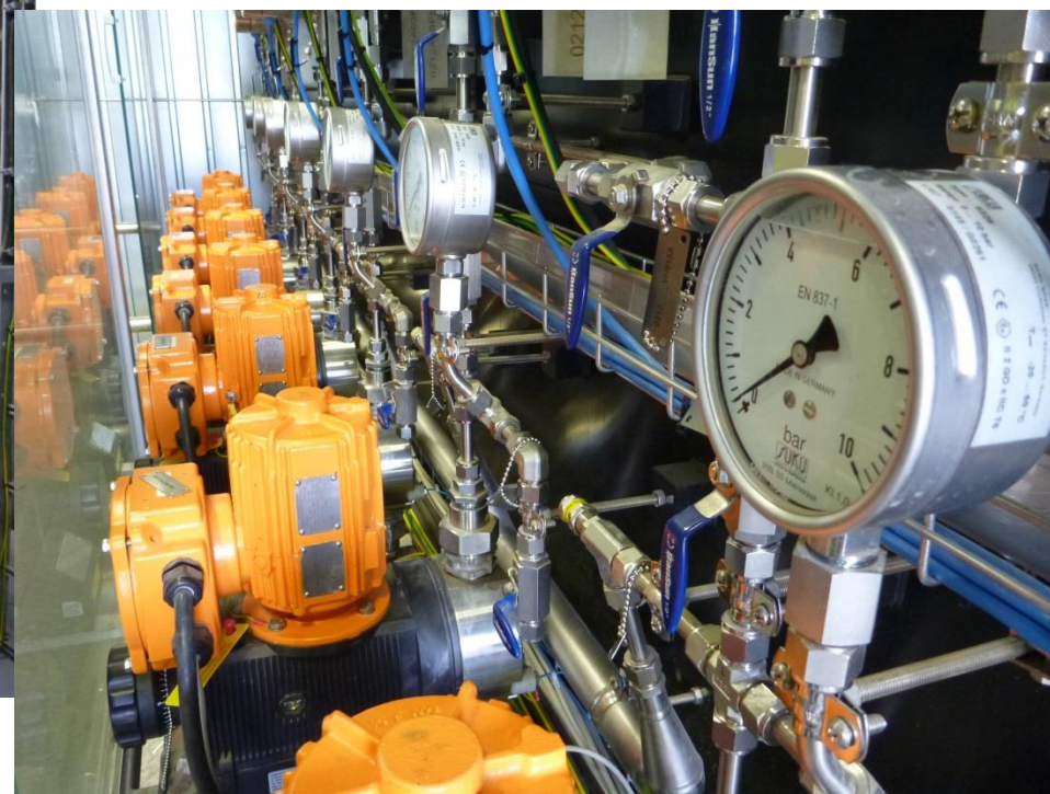
ÚČOV Praha - NVL Dávkovací čerpadla externího substrátu - metanolu
